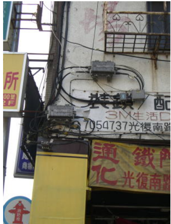
(建物の壁に取り付けられたアンプ)
