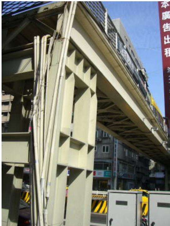
(写真：歩道橋に添架されたケーブル)
